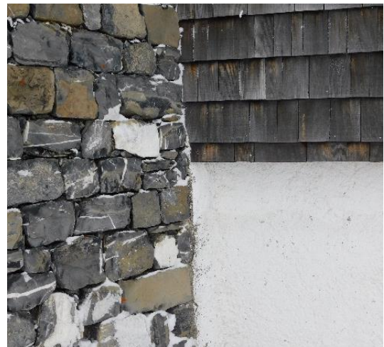
Exemple d'association des matériaux au Sosna
